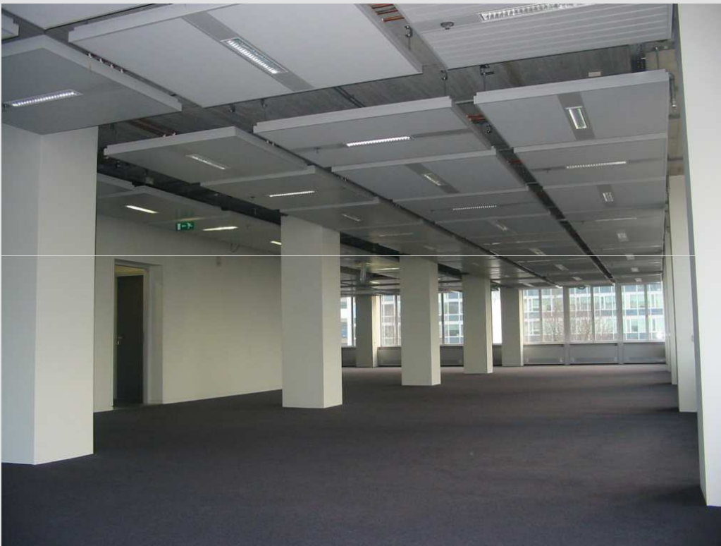
Koelplafonds met basis luchtverversing
