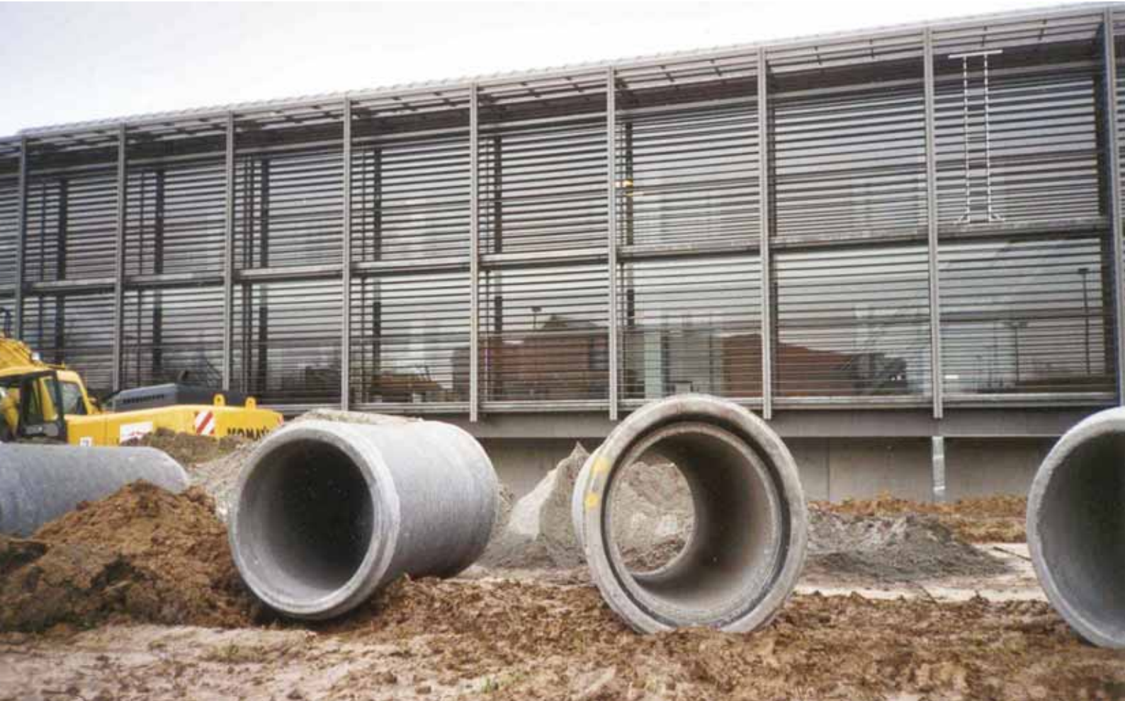
Figuur 5: De aarde – lucht warmtewisselaar van SD Worx bestond uit betonnen buizen op 3 en 5m diep.
