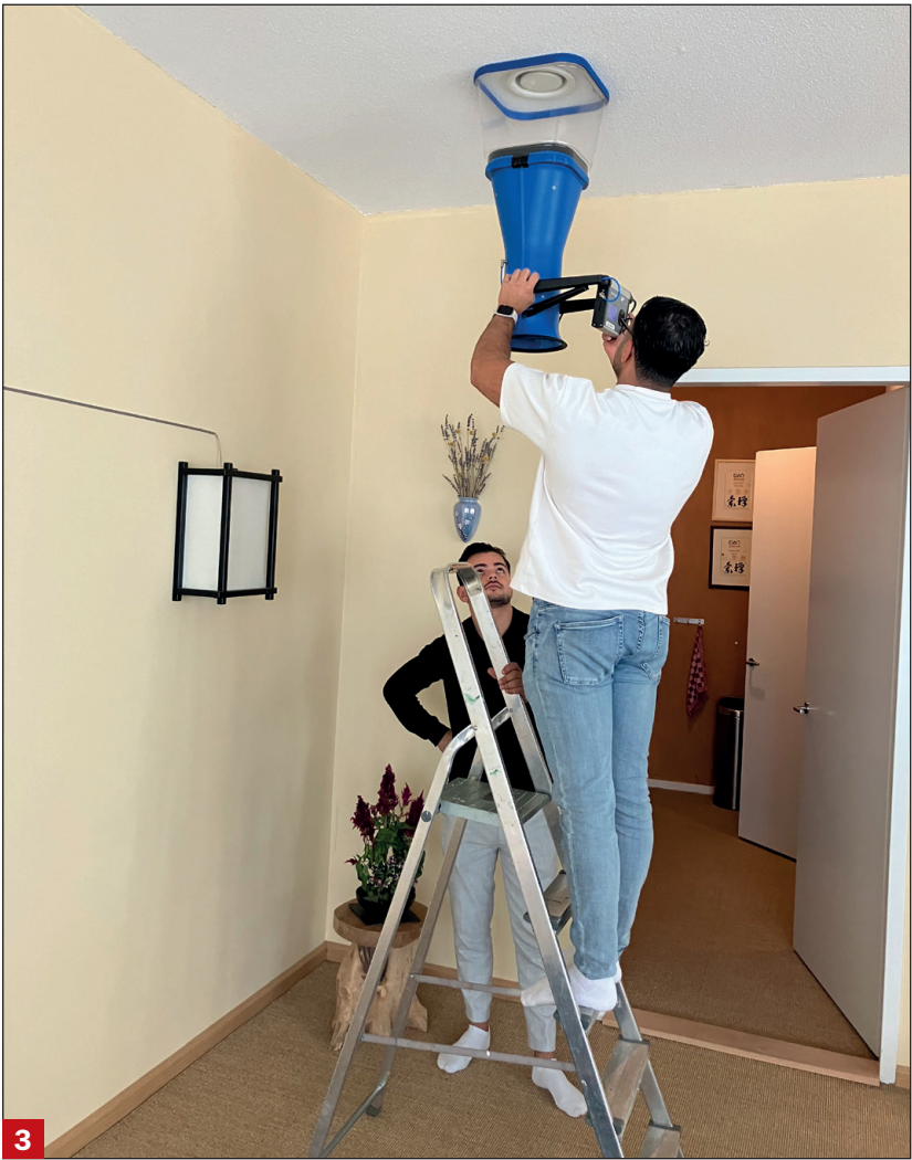
Ventilatiedebietmetingen met een balometer gebaseerd op nuldrukcompensatie
