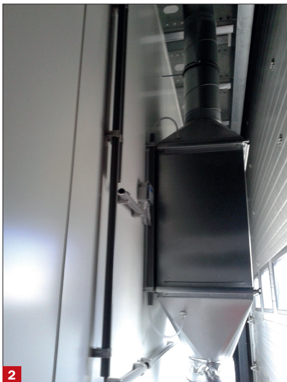
2 Ventilator en filter aan de buitenzijde van elke depotunit. Afzuiging gebeurt vlak boven de vloer; inblazen in het plafond aan de overliggende zijde. De filters zijn van EU9-kwaliteit
