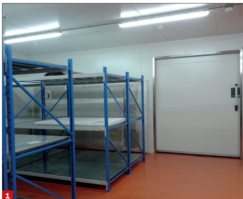
1 Binnenkant van een depotunit. De schuifdeur heeft een dubbele dichting; de LED-verlichting is voorzien van bewegingsdetectie en in het plafond zijn enkele inblaasopeningen zichtbaar
